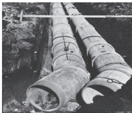
写真2 石綿管（水道管） （クボタのパフレットより）
