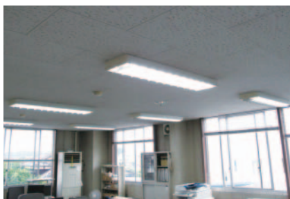
▲照明のLED化による 省エネ対策
